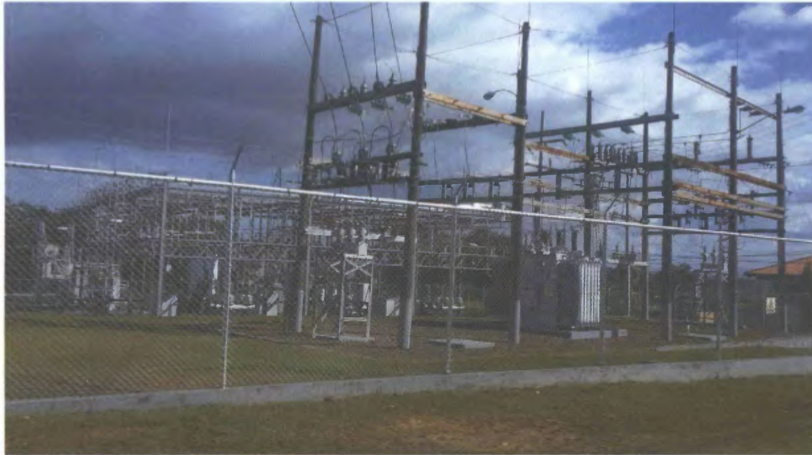
Fig. 22 Instalaciones del sistema de luz eléctrica de Santiago
