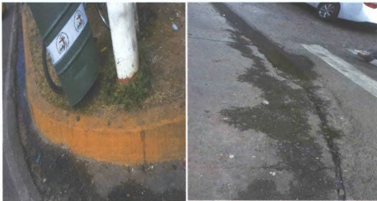
Fig. 19 Cunetas y llaneras de calles y avenidas del corregimiento de Santiago
